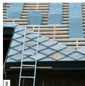
3/4. Montering av Otta firkantstein på hyttetak. Installation of Otta square schist on a cabin roof.
